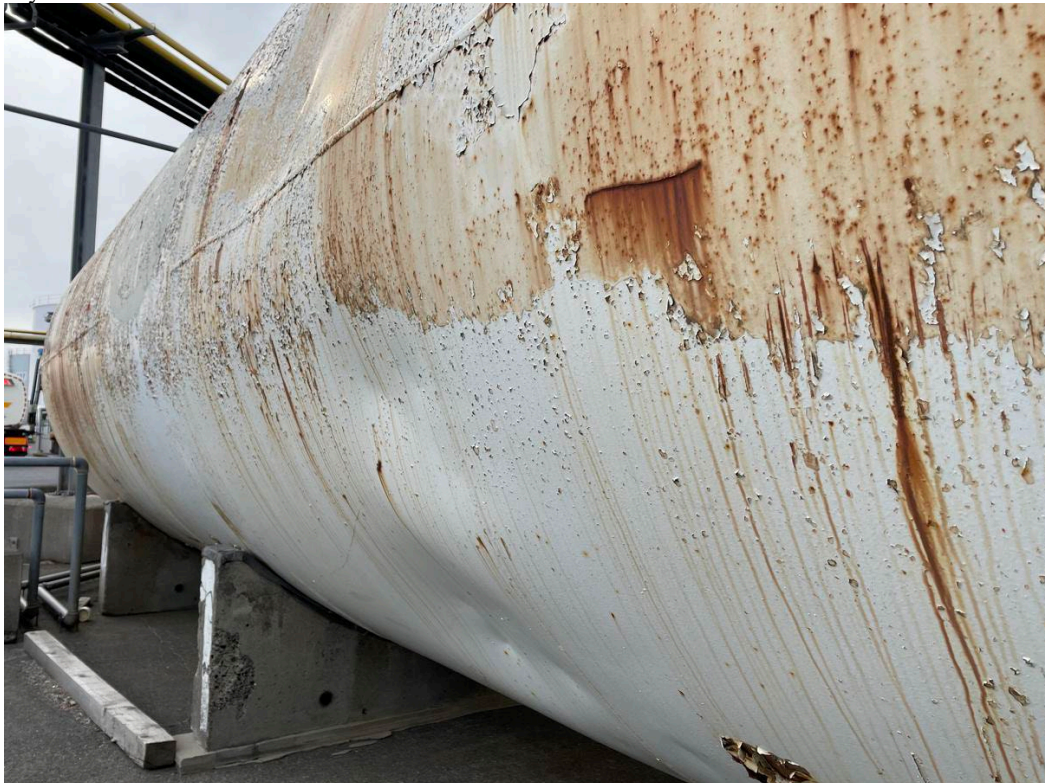
Mynd 4. Suðurhlið er dælduð á kafla.
